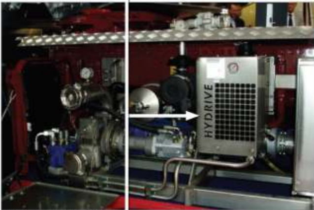
Montage unter dem Rahmen
